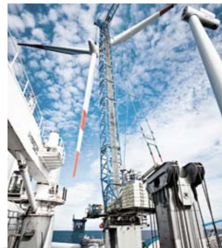
Der Ausbau der Windkraft hat für die EnBW hohe Priorität.
