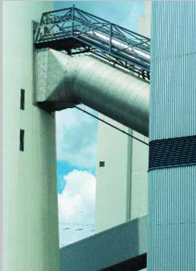
Verbindung zwischen Rauchgas- entschwefelungsanlage und Kamin von Heizkraftwerk 2
