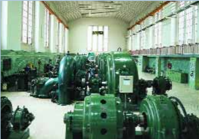
Maschinensätze in der Maschinenhalle des Murgwerks
