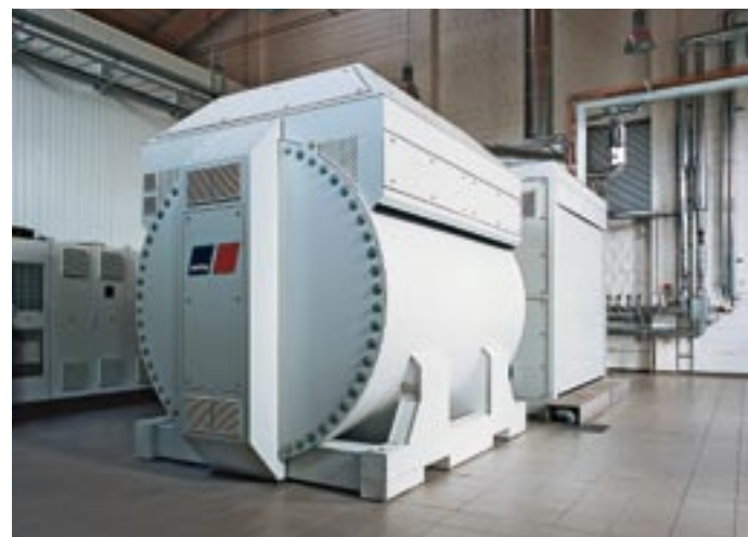
CFC Solutions Brennstoffzellen-Anlage in Leonberg
