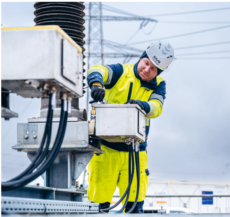
Im Stromnetz ist an vielen Stellen modernste Technik zu finden. Sie muss besonders widerstandsfähig sein. Die Schutzmechanismen werden deshalb laufend verbessert.
