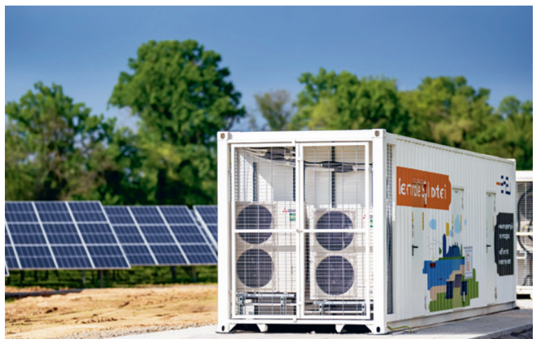
Batteriespeicher in unmittelbarer Nähe zu Wind- oder Solarparks wie hier in Bruchsal helfen bei Stromengpässen. Das trifft nicht auf alle Speicher zu.
