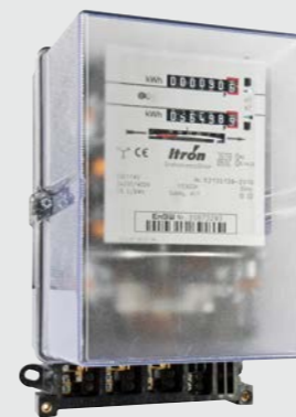
Der Zähler im Keller zeigt den Stromverbrauch an. Erfassen die Netzkunden ihn online, spart das jede Menge Porto.
