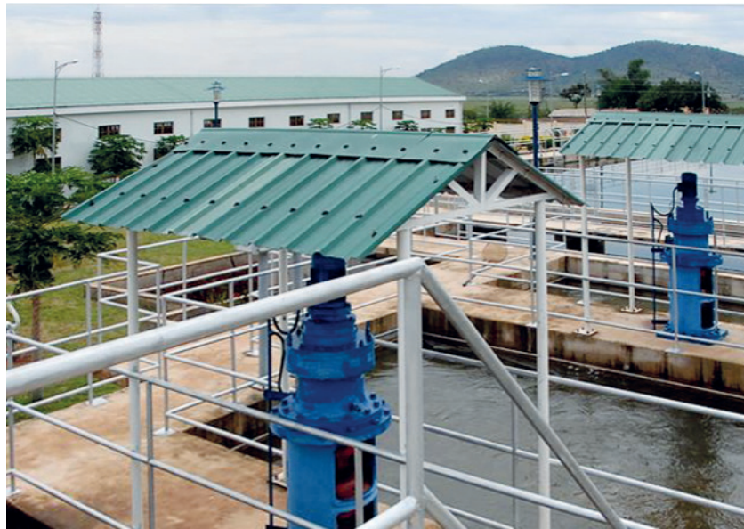
Neue Trinkwasseraufbereitungsanlage bei Ihelele in Tansania
