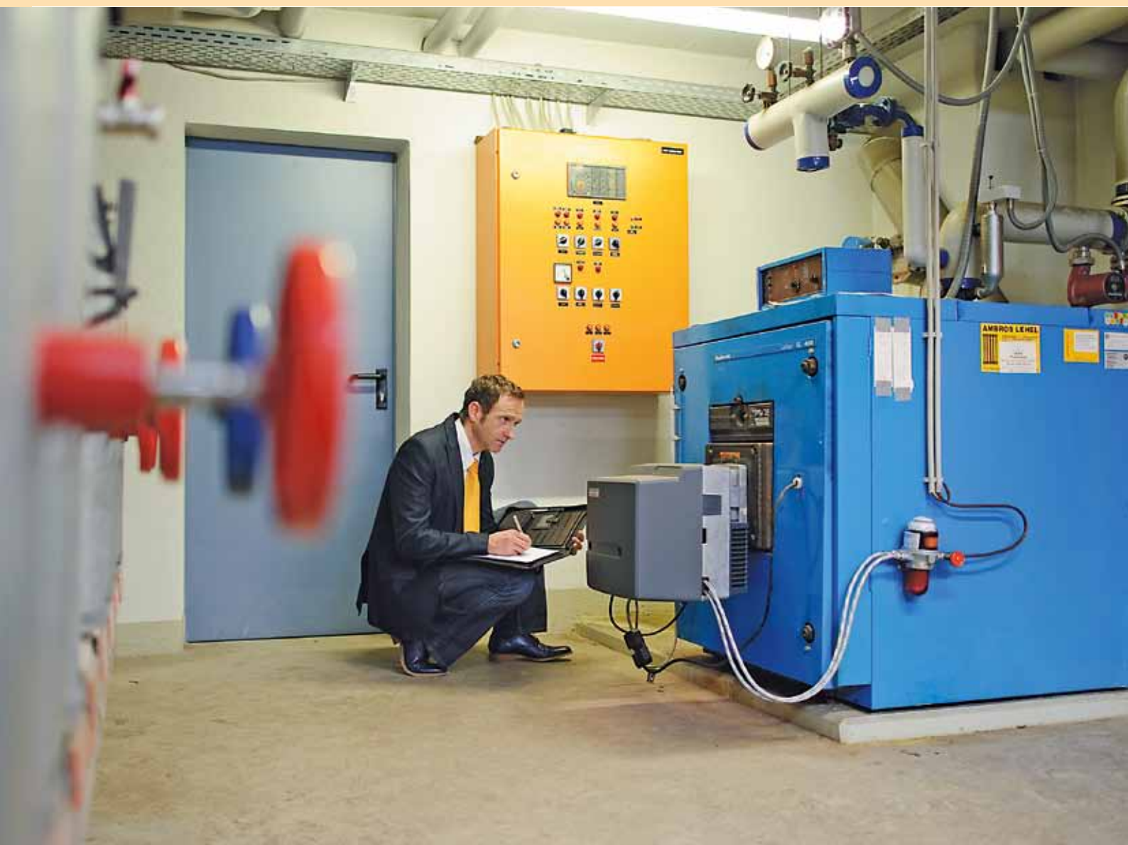
Roland Orth, Energieberater bei der EnBW, analysiert den Energieverbrauch im Rathaus.
