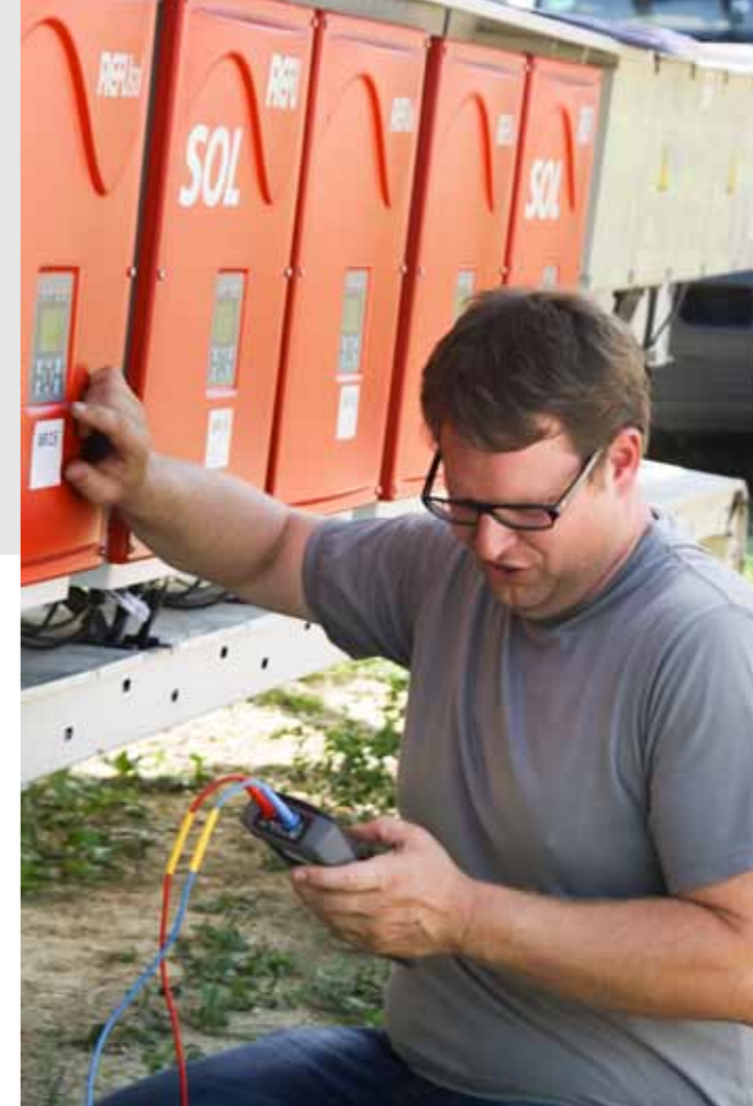
Sorgfältig überprüft Sven Gnirß die Leistungsfähigkeit der PV-Anlage.
