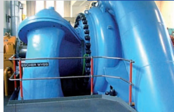
Die Speicherpumpe im Maschinenhaus.
