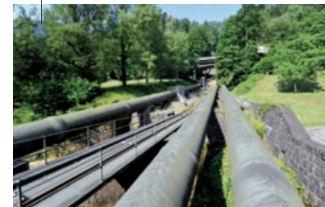
Über diese Rohrleitungen erreicht das Wasser sein Ziel im Maschinenhaus.
