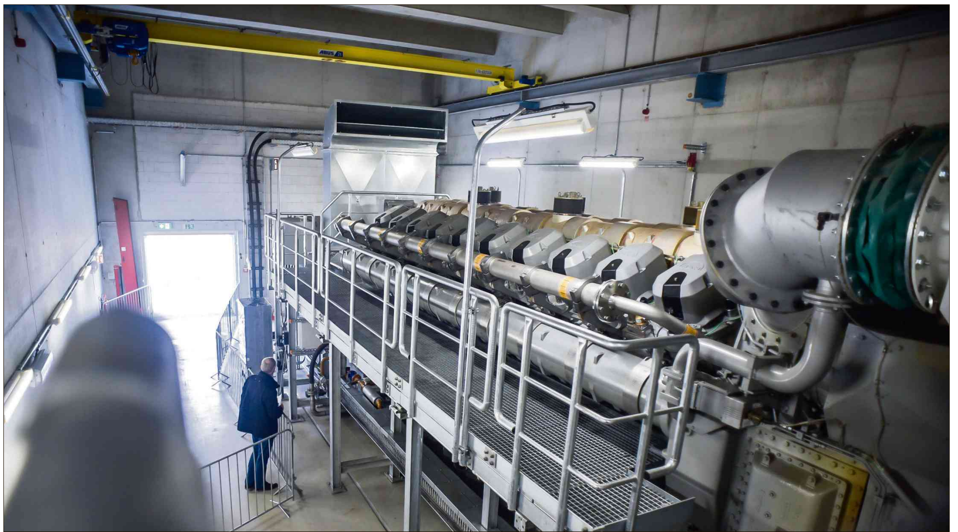
Blick in die neue Anlage in Gaisburg, in der Fernwärme und Strom erzeugt werden: Dazu sind fünf Kessel, die mit Gas betrieben werden können, und drei Gasmotoren installiert worden.
