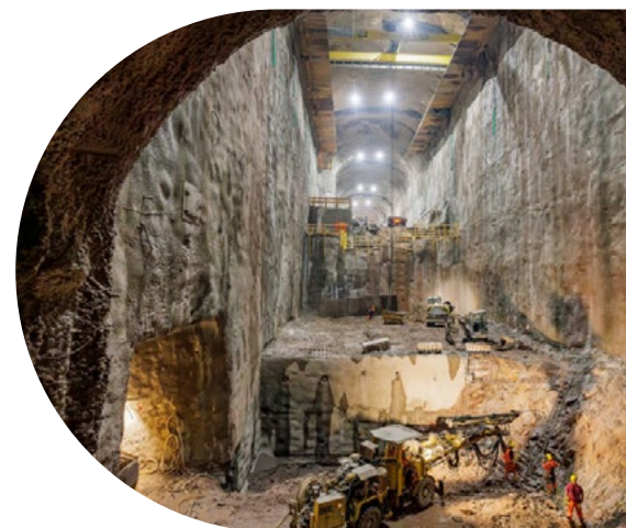
Das Maschinenhaus des Kavernenkraftwerks ist tief im Berg gelegen.
