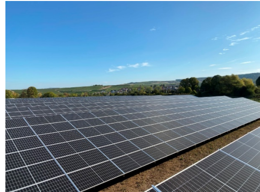
Solarpark Welgesheim (Foto EnBW/HÖRMANN)
